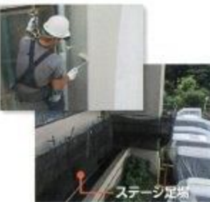
ステージ足場
